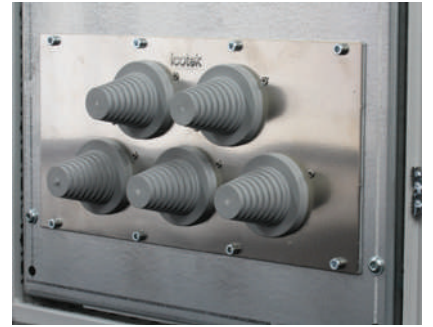
Rittal TS 8 panosuna modül plakası ile bölmelerden kablo girişleri sağlanmış.
